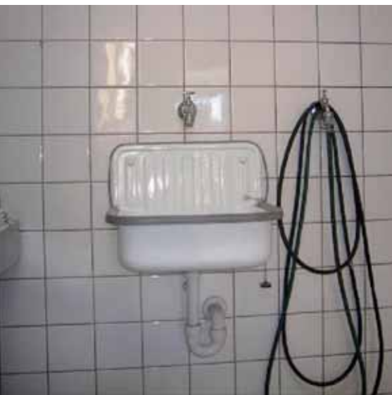
Einfaches Handwaschbecken (ohne Warmwasser!) mit Seifenspender. Stoffhandtücher sind okay, wenn sie regelmäßig gewechselt werden.
