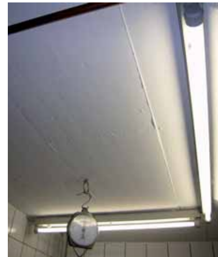
Ausreichende Beleuchtung ist gegeben, aber hier fehlt ein Splitterschutz! Bei einer Beschädigung von Neonröhren wird das Fleisch ggf. mit Splittern oder gar dem pulverigen Röhreninhalt kontaminiert (Gesundheitsgefahr!). Dann muss es entsorgt werden.
