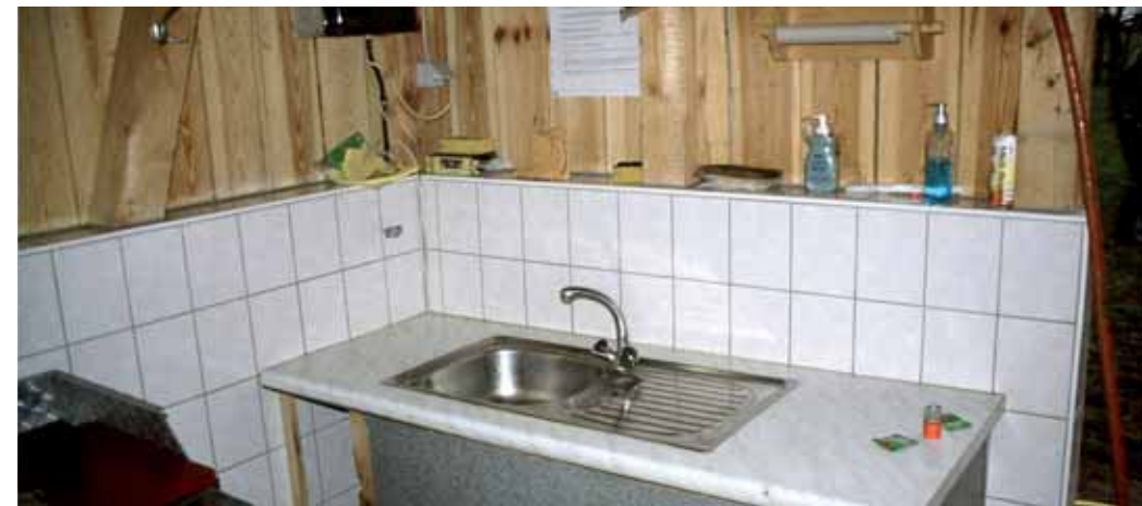
Notwendige Verbesserung: Das Holz über den Fliesen braucht einen abwaschbaren Anstrich.
