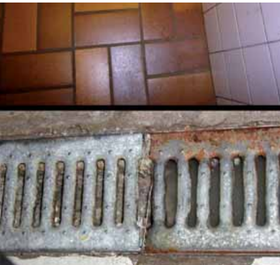
Ein Abfluss vereinfacht die Reinigung, verzinkte Abdeckungen oxidieren aber!
