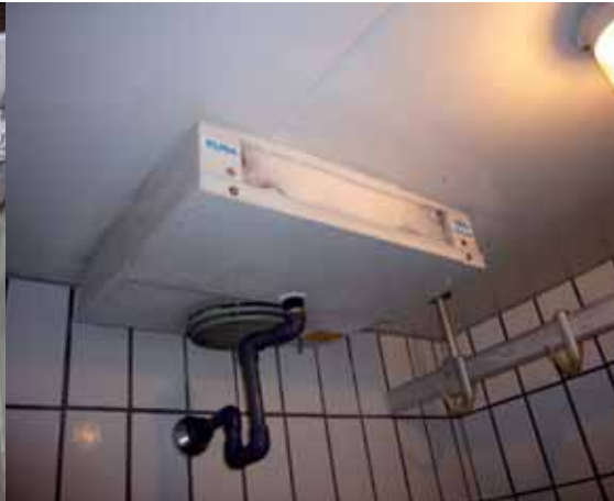
Dringend abtauen! Die Kühlleistung ist wegen Vereisung deutlich beeinträchtigt!
